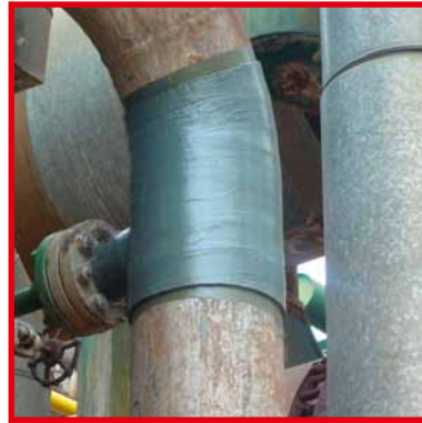
Σωληνώσεις και Βαλβίδες
